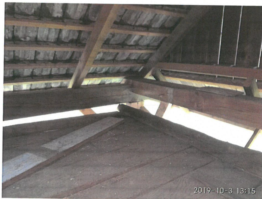
Fotografia 11: Szczelina między dachem z zrębem domu
